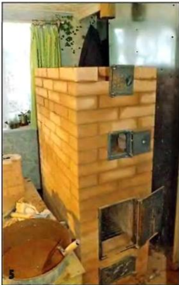
На фасаде печи установлены две прочистные дверки.
